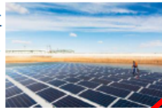
イビデンの太陽光発電設備
